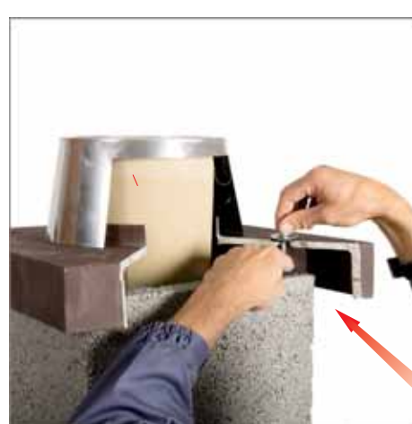
Dylatacja pomiędzy rurą ceramiczną a płytą przykrywającą. Doprowadzenie powietrza do spalania pod płytą przykrywającą.
