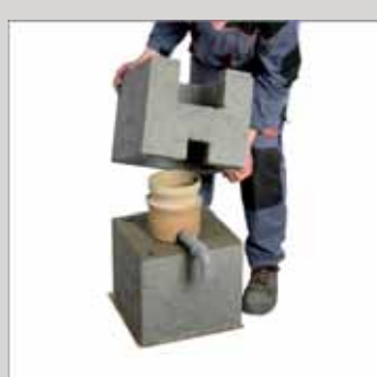
3. Osadzić pustak z wyciętymi otworami na rurkę do odpływu kondensatu i zewnętrzne drzwiczki czyszczaka
