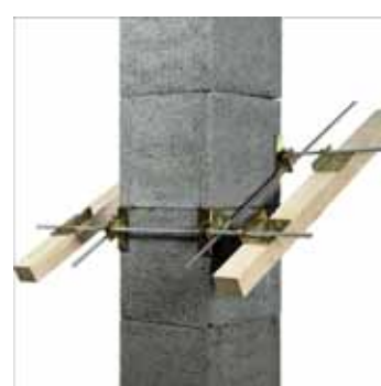
Usztywnienie kominu w miejscu przejścia przez połac dachową przy pomocy zestawu mocowanego do krokwi
